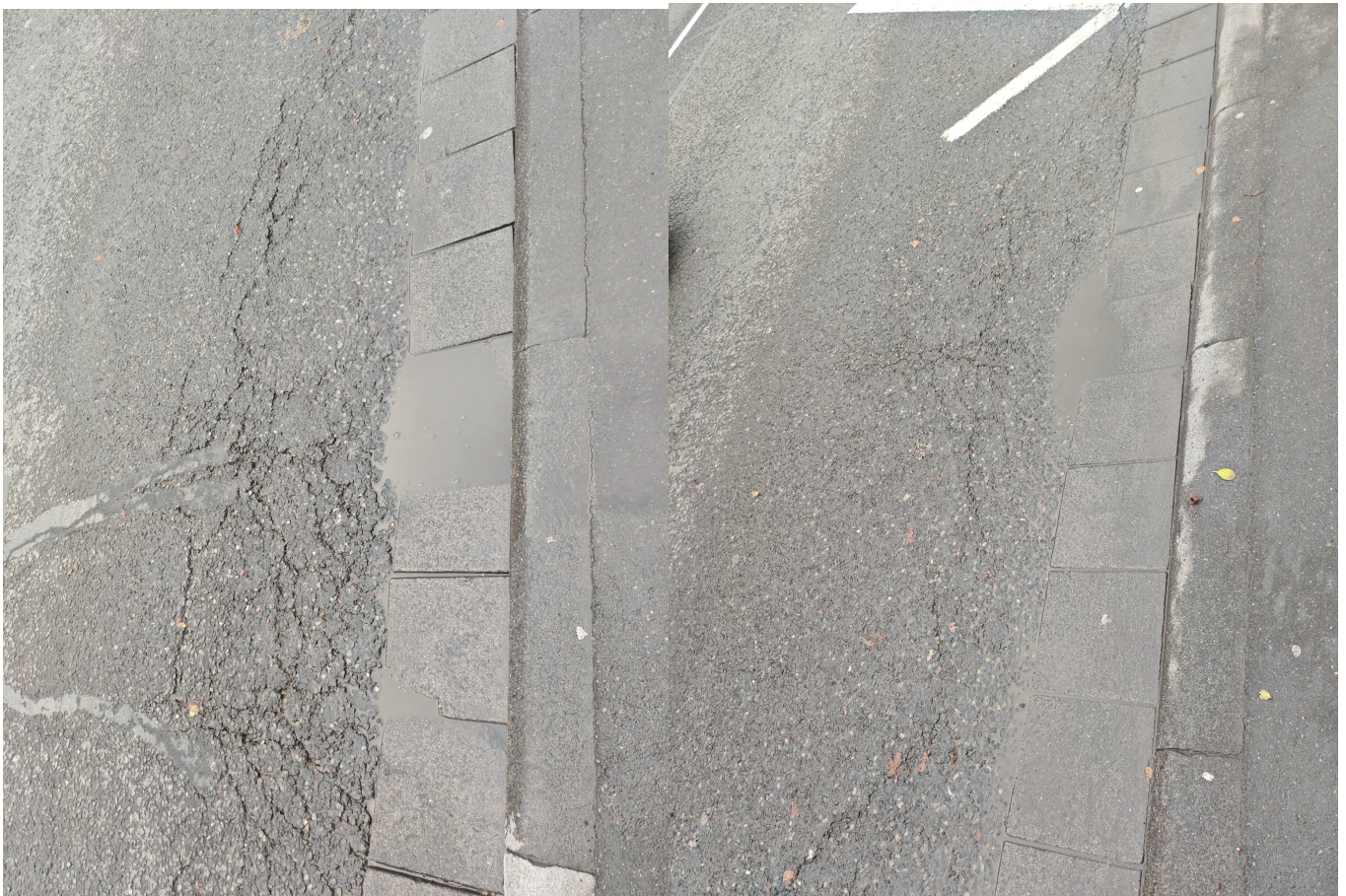
Abbildung 1-4: Ansicht der beschädigten Straße an der Bushaltestelle St. Veiter Platz.
