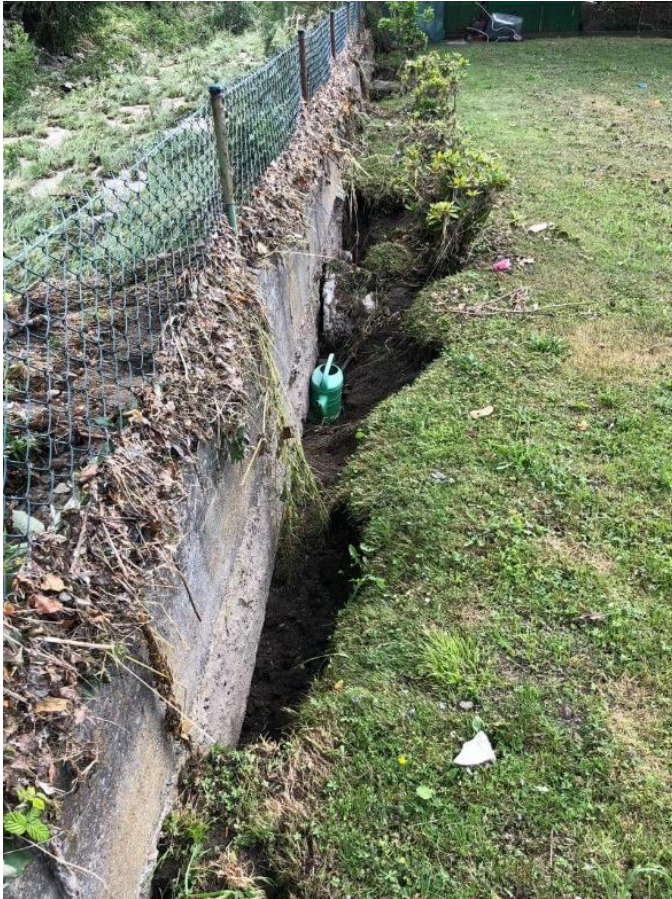
Hinterspülte Mauer in Kleingartenanlage
