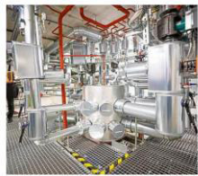
Im Rathaus wurde jüngst eine Fernwärme-Ärztin installiert. Architekt: Sascha Kopp
