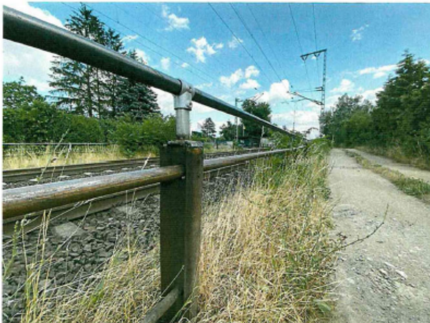
Aufstockung der vorhandenen, maroden und lückenhaften Barriere (wird regelmäßig überquert)
