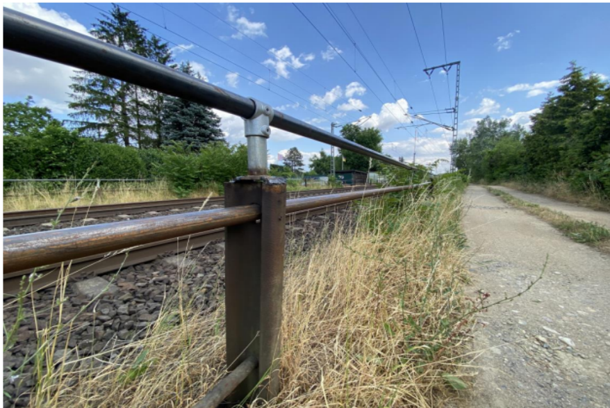
Aufstockung der vorhandenen, maroden und lückenhaften Barriere (wird regelmäßig überquert)
