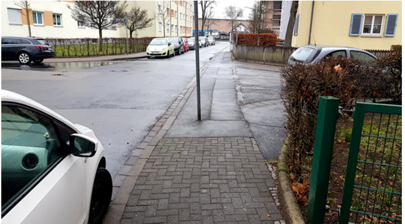
Abbildung 1: Die Abgrenzung des Gehwegs (nach rechts abbiegend) ist im Einmündungsbereich unklar. Die gepflasterte Gehwegkante endet unerwartet
