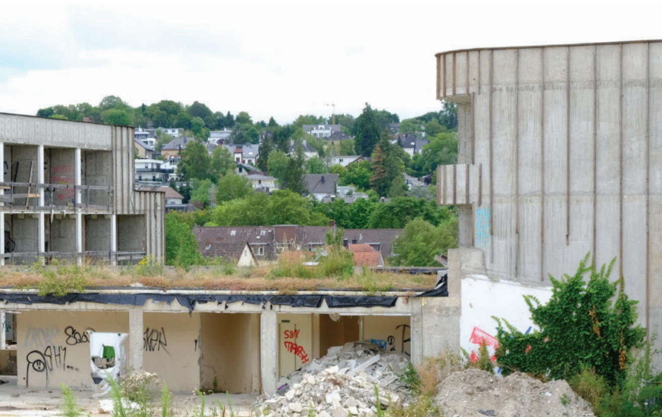
Die brachliegenden Gebäude der ehemaligen Klinik am Bingert
