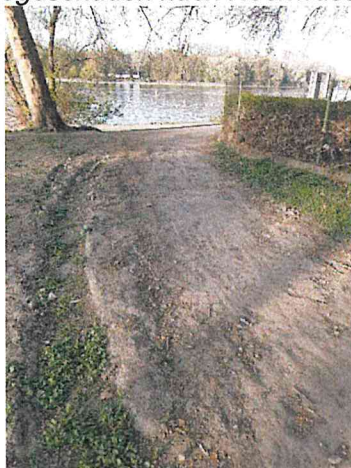
Wegeschaden nach Hochwasser
