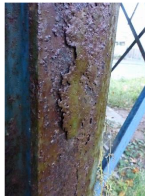
Abbildung 9 Korrosion der Stütze
