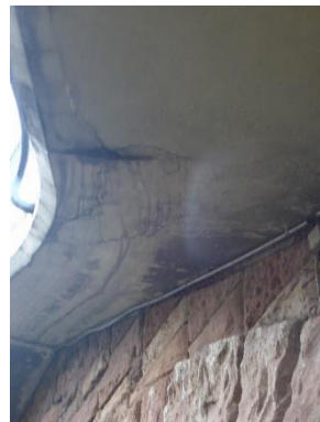
Abbildung 8 Betonschäden am Treppenaufgang
