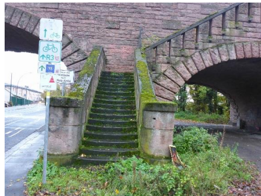
Abbildung 17 stillgelegter Treppenaufgang auf der Nordseite
