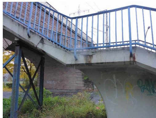
Abbildung 7 Betonschäden am Treppenaufgang
