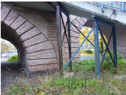
Abbildung 6 stark korrodierte Stahlkonstruktion
