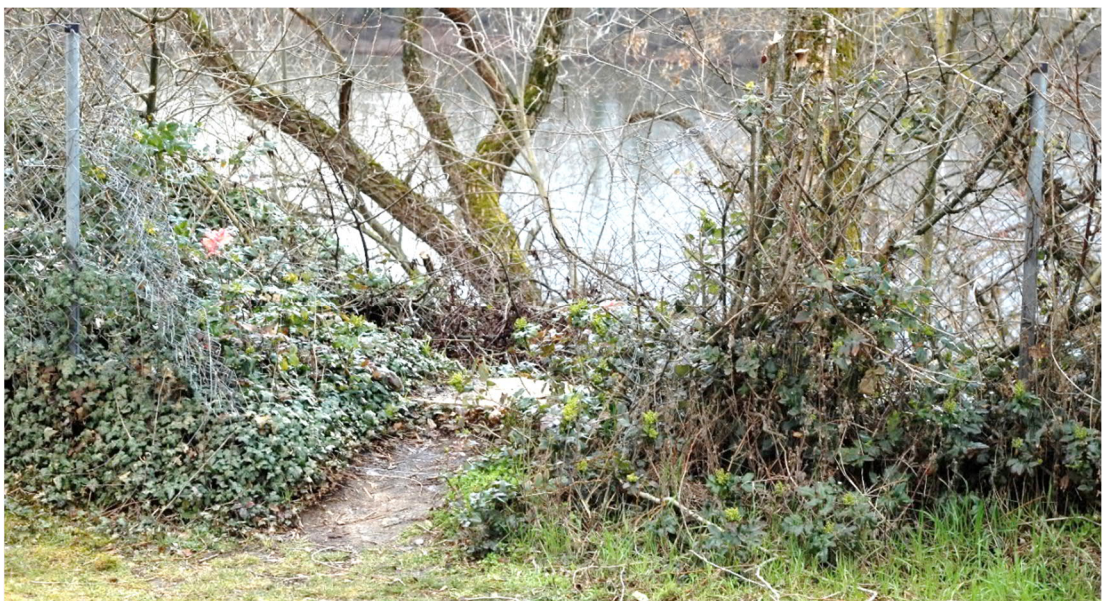
Abbildung 50: Mutwillig beschädigter Zaun an der Parkanlage
