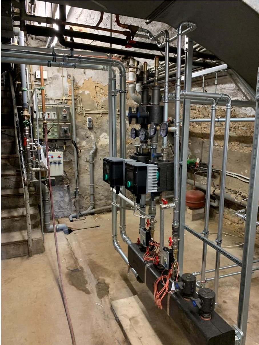
Technikzentrale linker Gewölbekeller
