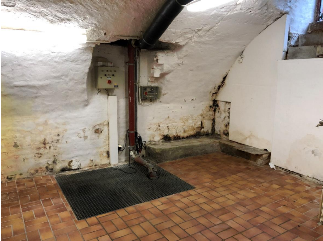
Rechte Gewölbekeller mit Hebeanlage und Substanzschäden
