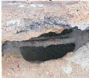
Fahrbahneinbruch nach Unterspülung
