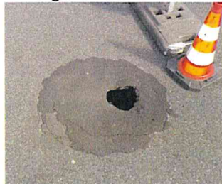
Fahrbahneinbruch vorgefundene Stelle
