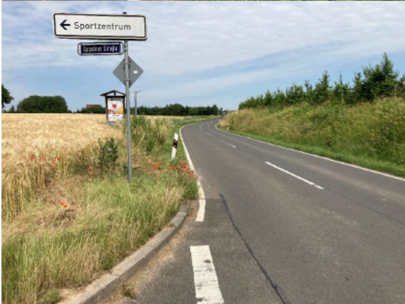
Von Süden kommend ist die Kurve einsehbar. Von Norden erst, wenn man frühestens mitten auf der Fahrbahn steht.
