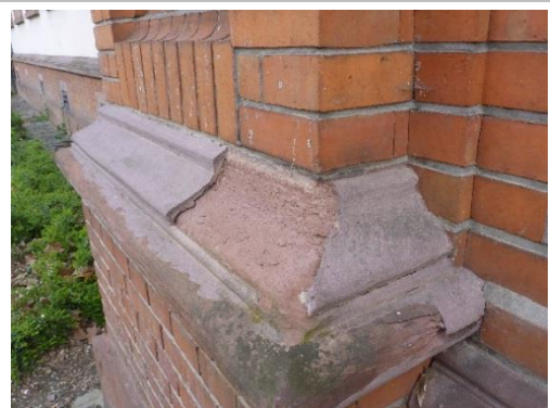
Abbildung 12 – Fassadenschäden am Hauptgebäude
