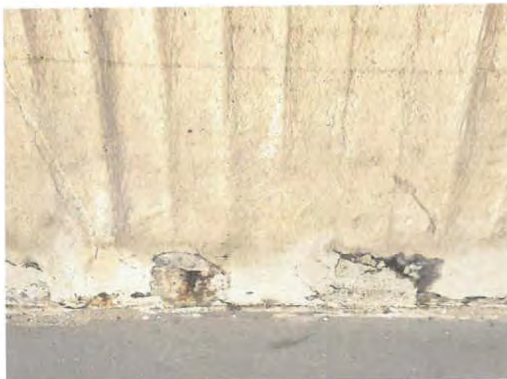
Bild 52: Achse B, Block 56: Betonabplatzungen, Bewehrungskorrosion
