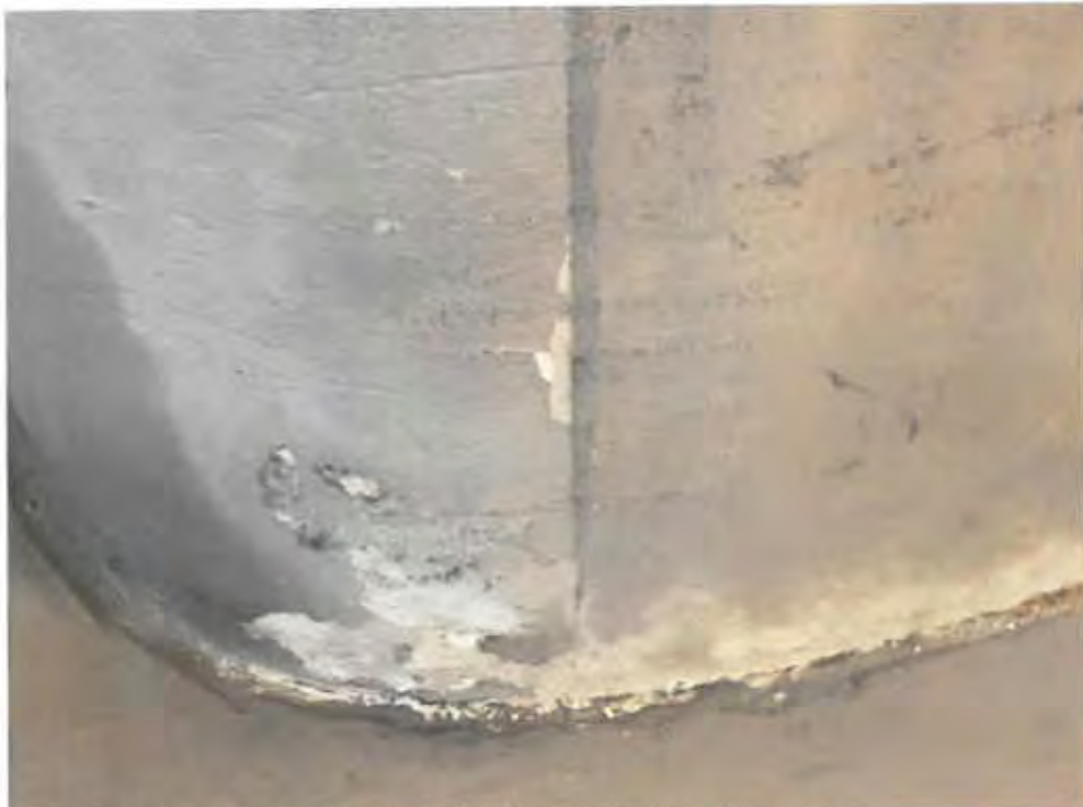
Bild 49: Achse B/L, Block 23: Schadstelle im Wandbereich
