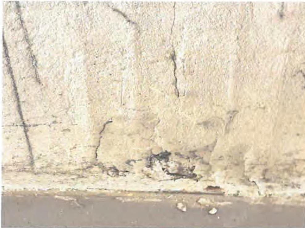
Bild 53: Achse B, Block 54: Betonabplatzung, Bewehrungskorrosion
