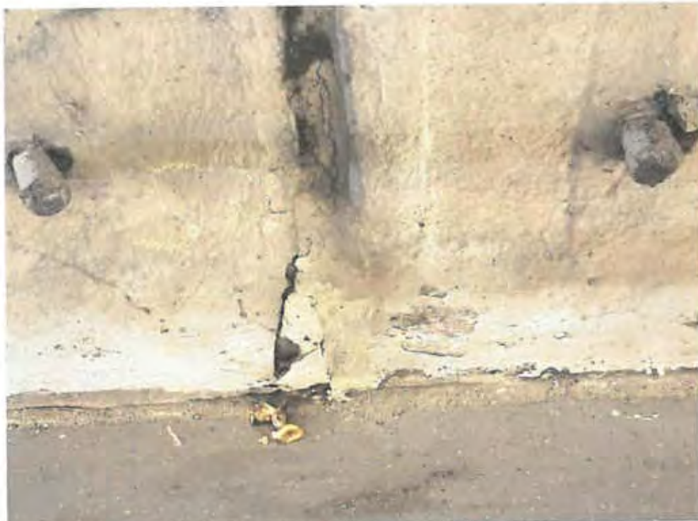
Bild 51: Achse B, Block 56/57: Schadstelle im Wandfußbereich
