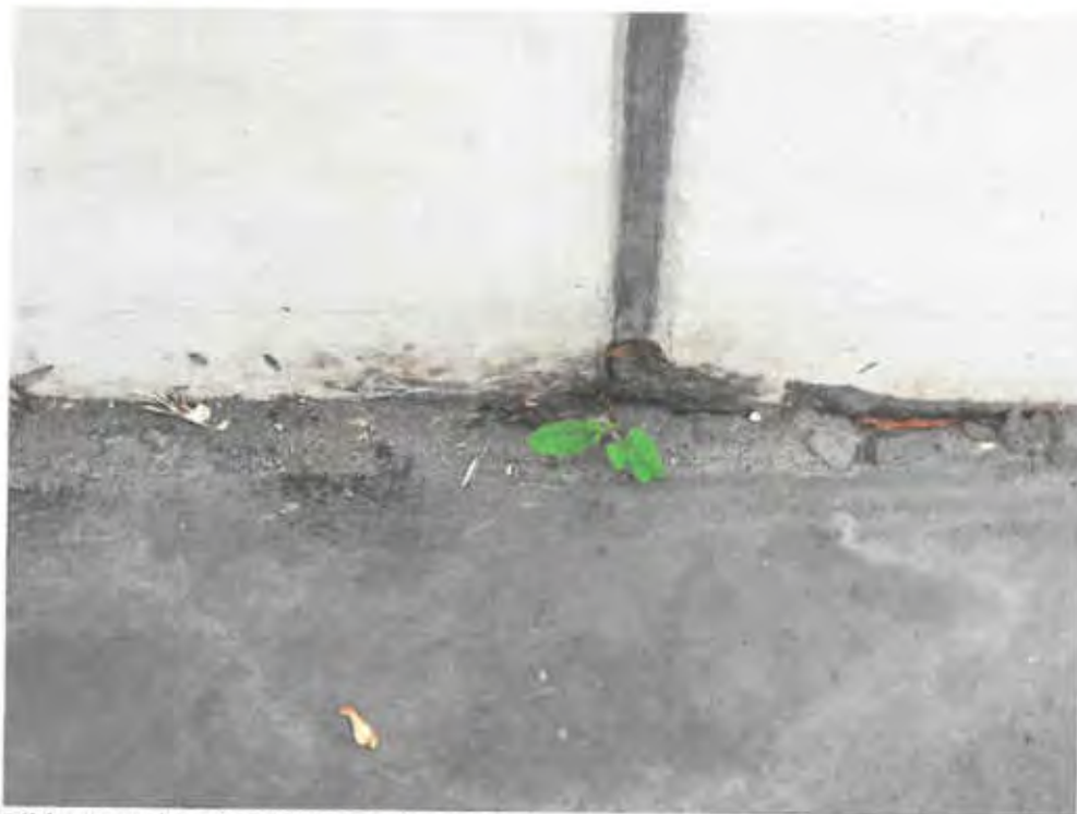
Bild 112: Achse C: schadhafte Anschlussfuge
