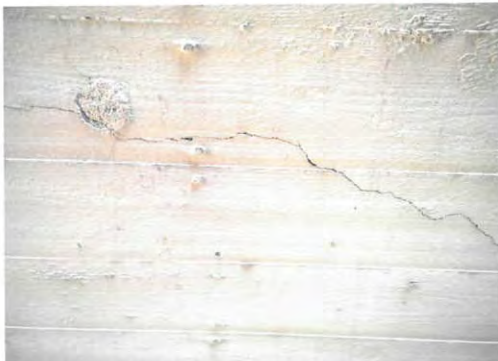
Bild 65: Deckenunterseite: Sichtbeton, Rissbildung
