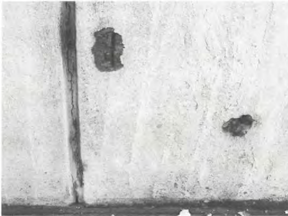
Bild 29: Achse B, Block 51: Betonabplatzungen, Bewehrungskorrosion
