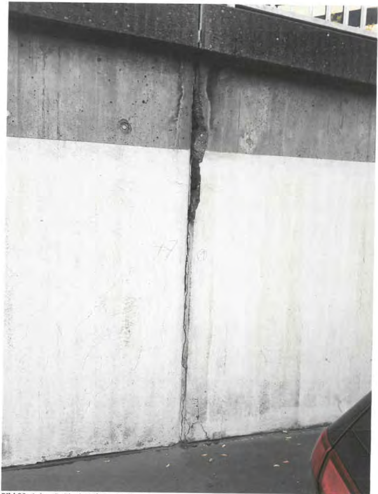
Bild 99: Achse B, Block 47/46: schadhafte Bewegungsfuge
