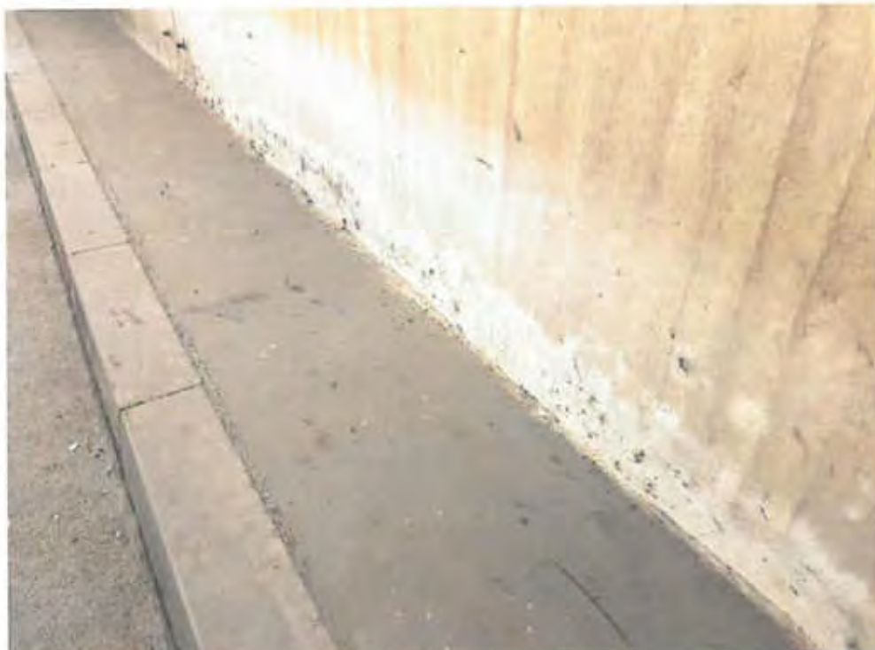
Bild 50: Achse B, Block 57: schadhafter Wandbereich
