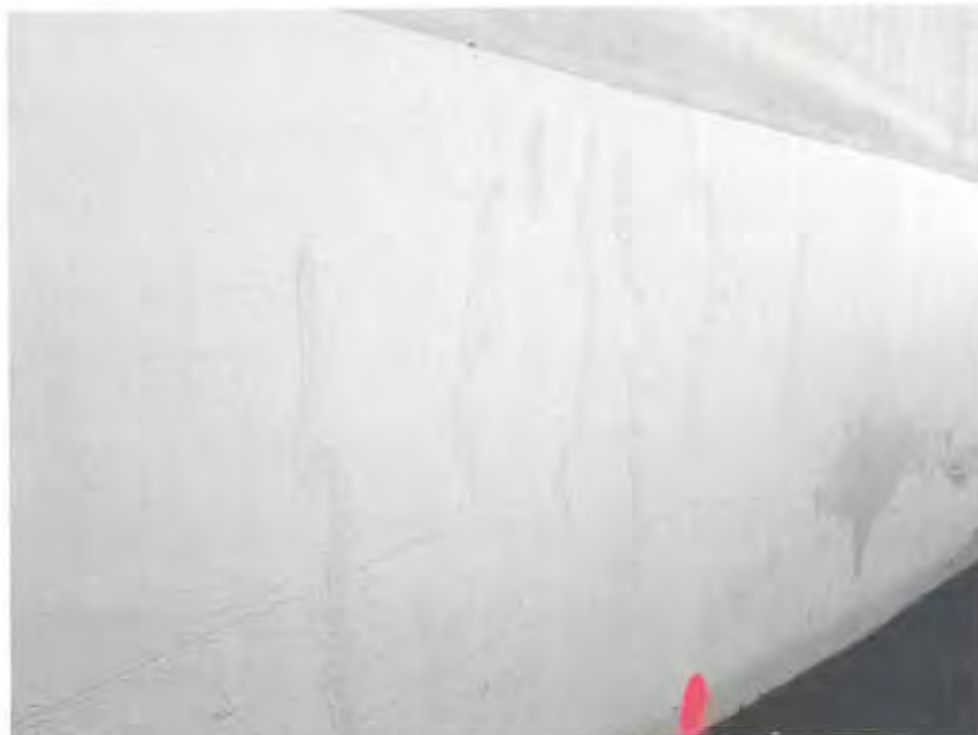
Bild 44: Achse D, Block 12: verspachtelter Rissverlauf
