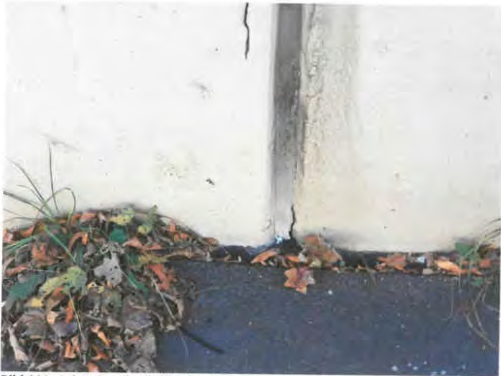
Bild 111: Achse D: schadhafte Anschlussfuge
