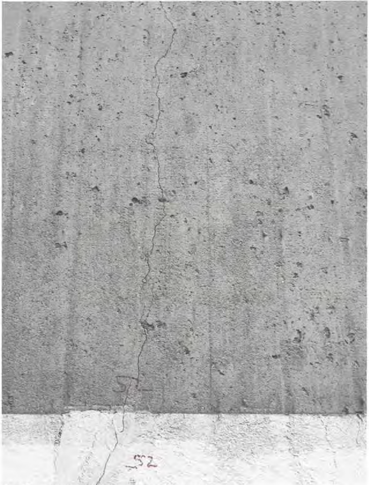
Bild 15: Achse B, Block 52: Sichtbetonfläche mit hoher Porigkeit
