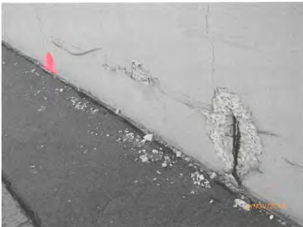
Bild 26: Achse A, Block 34: Betonabplatzungen, Bewehrungskorrosion
