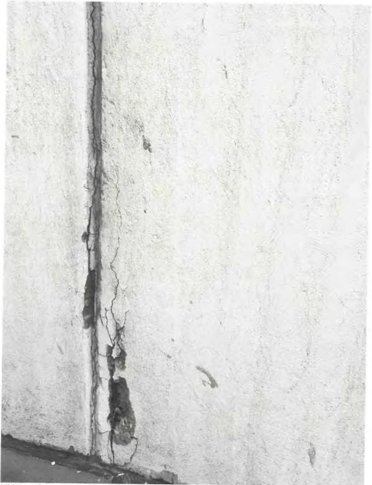
Bild 97: Achse B, Block 50/49: schadhafte Bewegungsfuge
