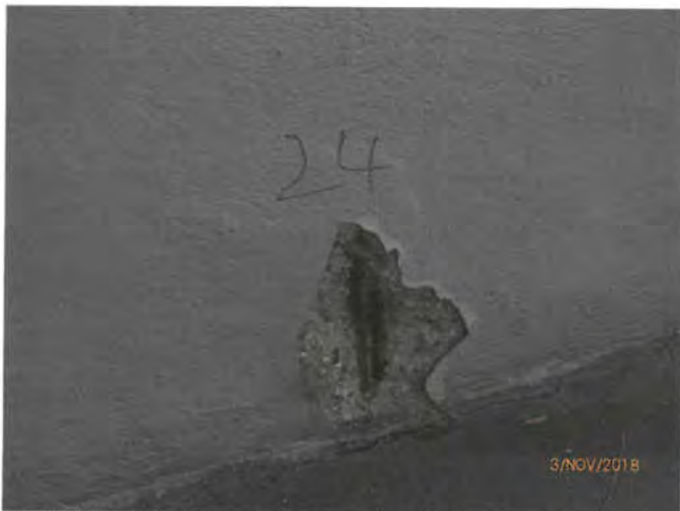
Bild 28: Achse A, Block 24: Betonabplatzung, Bewehrungskorrosion
