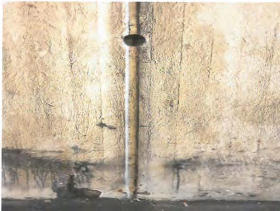
Bild 54: Achse B, Block 53/54: Betonabplatzung, Bewehrungskorrosion, Entnahmestelle BK 53 F
