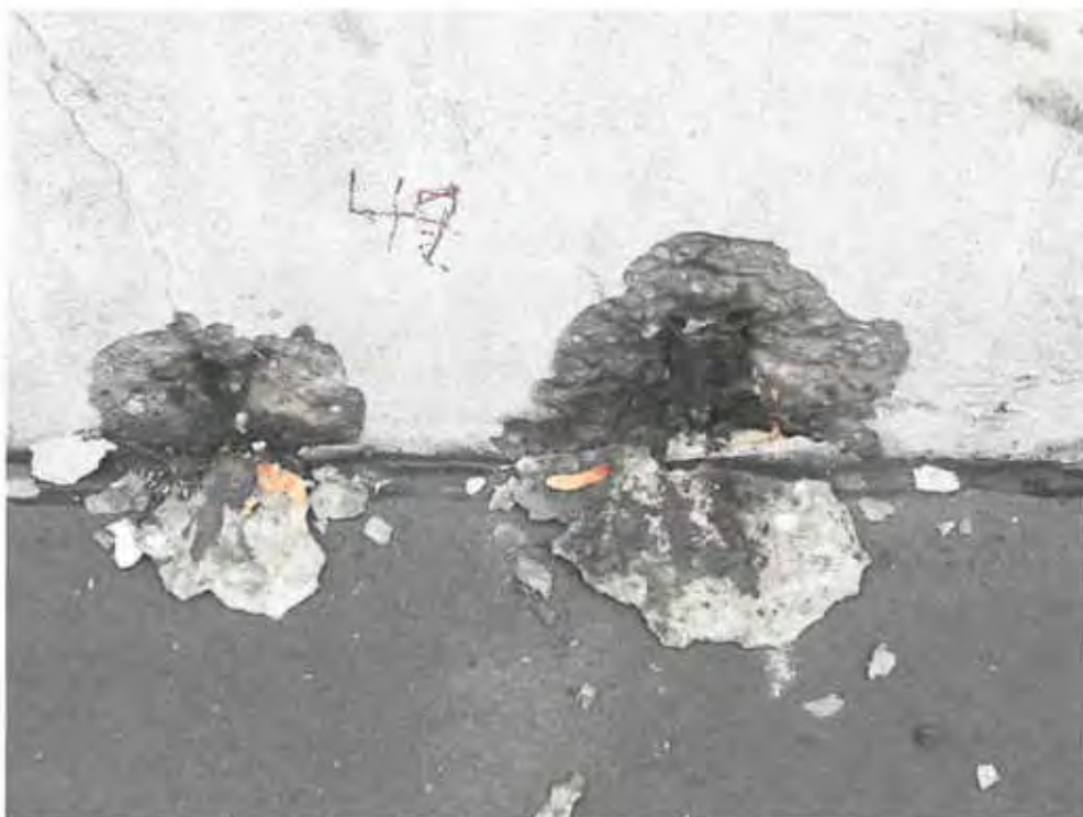
Bild 30: Achse B, Block 49: Betonabplatzungen, Bewehrungskorrosion
