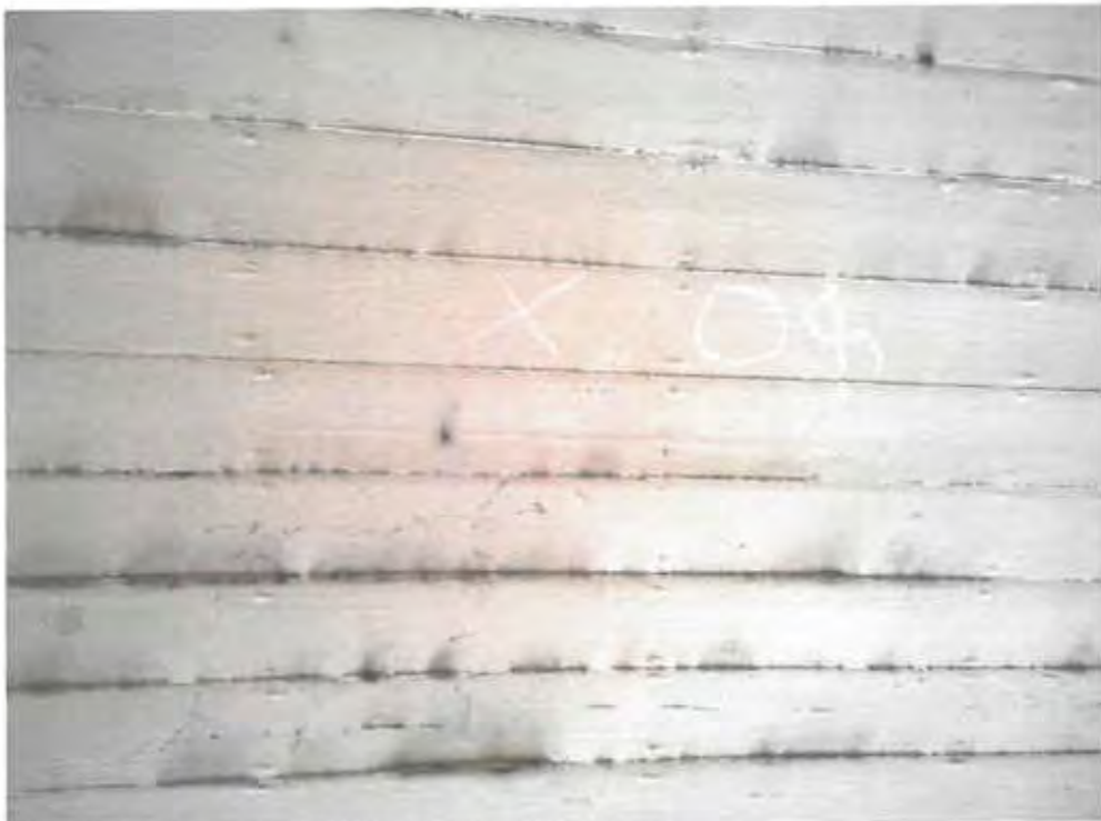
Bild 68: Deckenunterseite: Sichtbeton, Rissbildung
