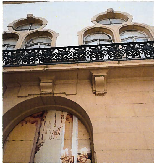
Abb. 60 Fassade Mauritiusstraße, Rissverlauf, Sept 2017
