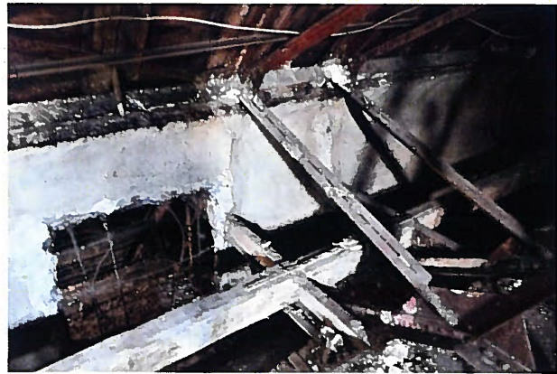
Abb. 21 Dachwerk über dem Festsaal, nach Westen, Reste des Luftkanals in Rabitz-Bauweise. Sept. 2017
