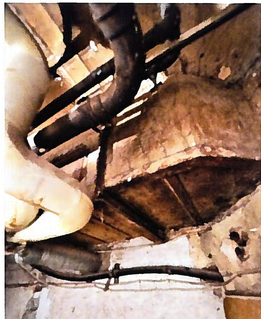
Abb. 56, Raum U1.D.42 mit Teil der Luftkanal der zweiten Bauphase, Sept. 2017
