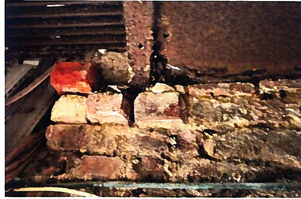
Abb. 62 Raum U1.D72 Decke, Stahlträger, Gitterrost und Stahlplatte, Mauerwerk, Ergänzungen, Salz- und Feuchtelastung, Sept. 2017
