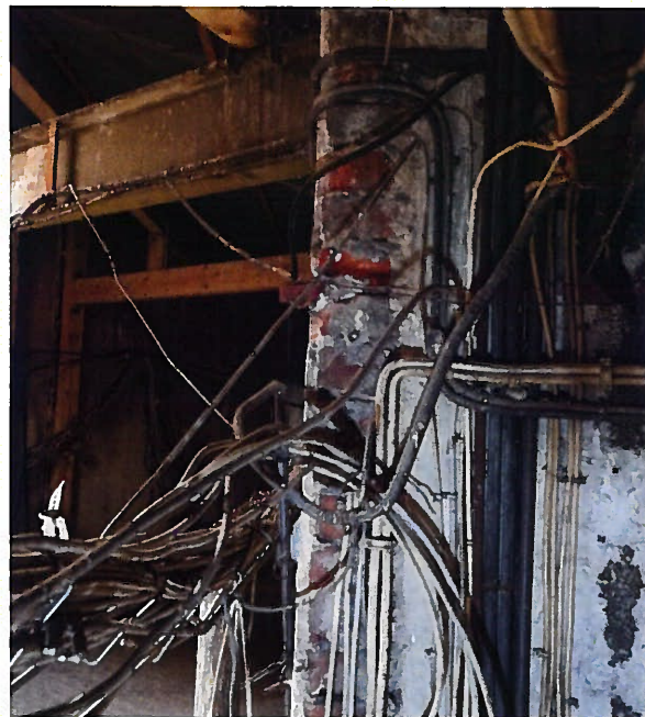
Abb. 63 Dachraum Mauritiusstraße, Zustand der Haus-technische Anlagen, Sept. 2017
