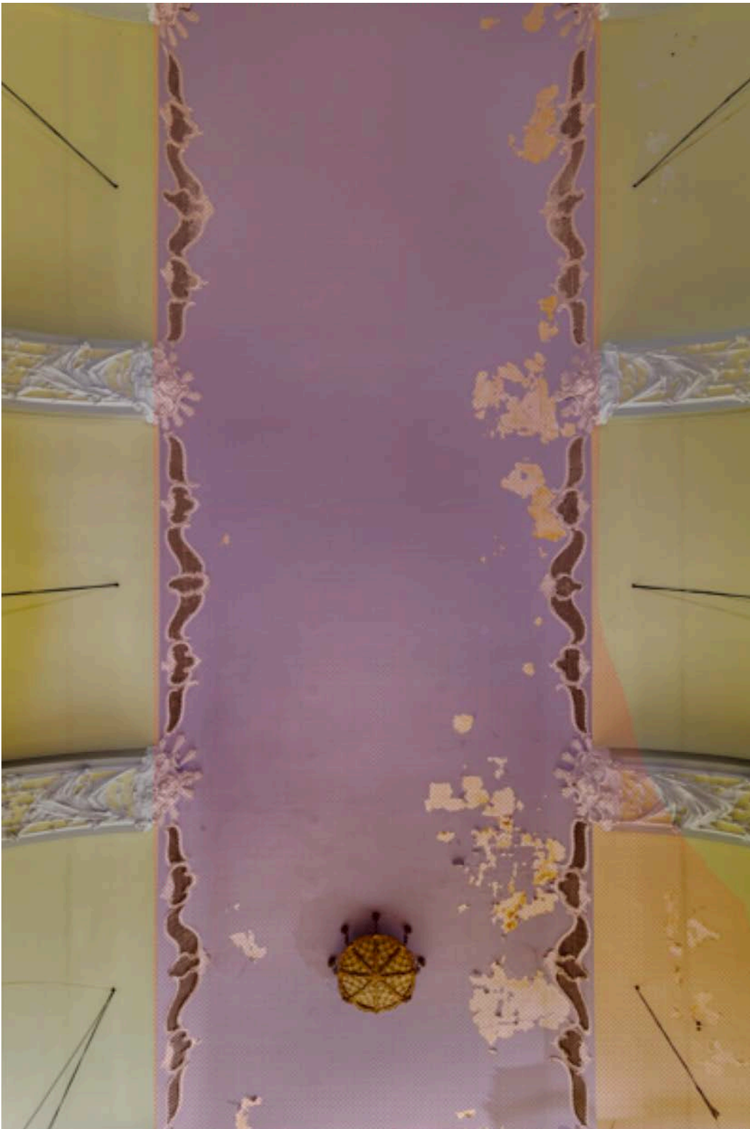
Abb. xx, „20170929_030477_HDR.TIF“ Schadensbild abblätternde Anstriche (Dispersionfarben).
