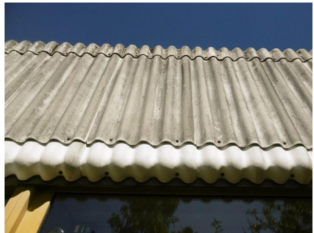
Abbildung 16 Ansicht von Südwesten, Asbestbindung durch Anstrich der Attika
