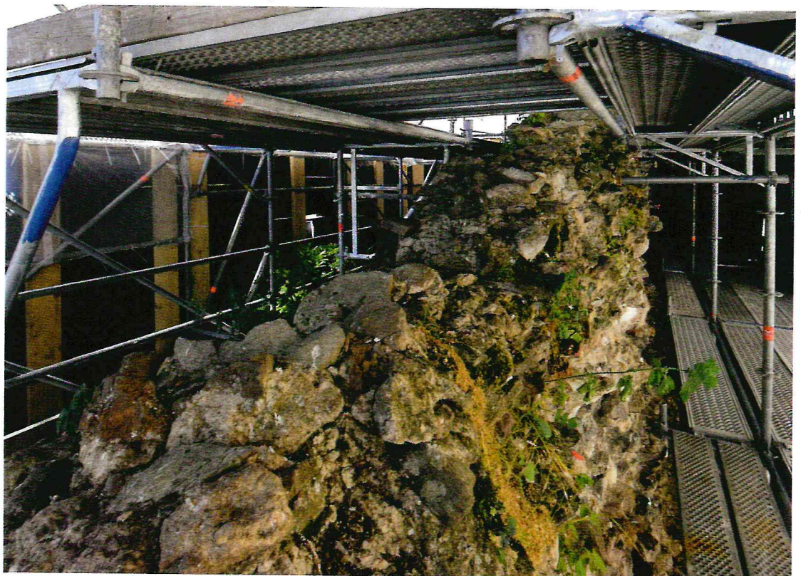
Abb. 13: Blick auf die Abbruchkante der unteren Mauer. Die rechte, nördliche Mauerflanke ist weitgehend in der Ursprungsgeometrie erhalten, die stets zugängliche Südseite (links) ist stark abgearbeitet. Foto: Ch. Kayser, Barthel & Maus
