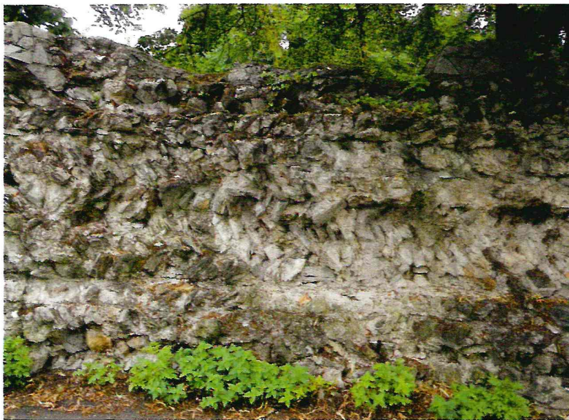
Abb. 5: Südseite der Plateaumauer mit dem charakteristischen „Fischgrät“-Verband im Kernmauerwerk. Die Fugen zwischen den einzelnen „Betonierabschnitten“ zeichnen sich deutlich ab. Foto: Ch. Kayser, Barthel & Maus
