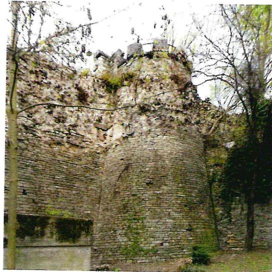
Abb. 14: Nordseite der „Hangmauer“ mit dem Heidenturm. Die bis zu sechs Meter hohe Untermauerung entstand um 1880 als Sicherungsmaßnahme. Links unten der ehemalige Zugang zu den Luftschutzkellern des Zweiten Weltkrieges. Foto: Ch. Kayser, Barthel & Maus
