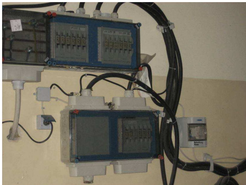
Foto 9) Elektro im Treppenraum Hochstättenstraße über 1. OG
