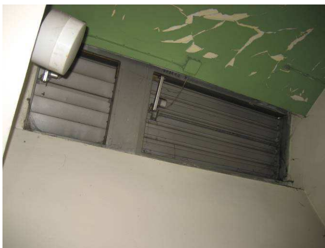
Foto 11) „Rauchklappe“ Treppenraum Hochstättenstraße
