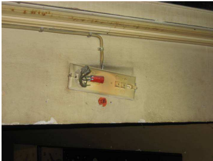
Foto 13) Deaktivierung einer ehemals beleuchteten Rettungswegkennzeichnung
