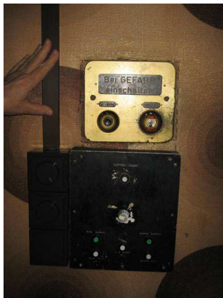
Foto 4) Altinstallation Notlicht; ohne Ersatz außer Funktion
